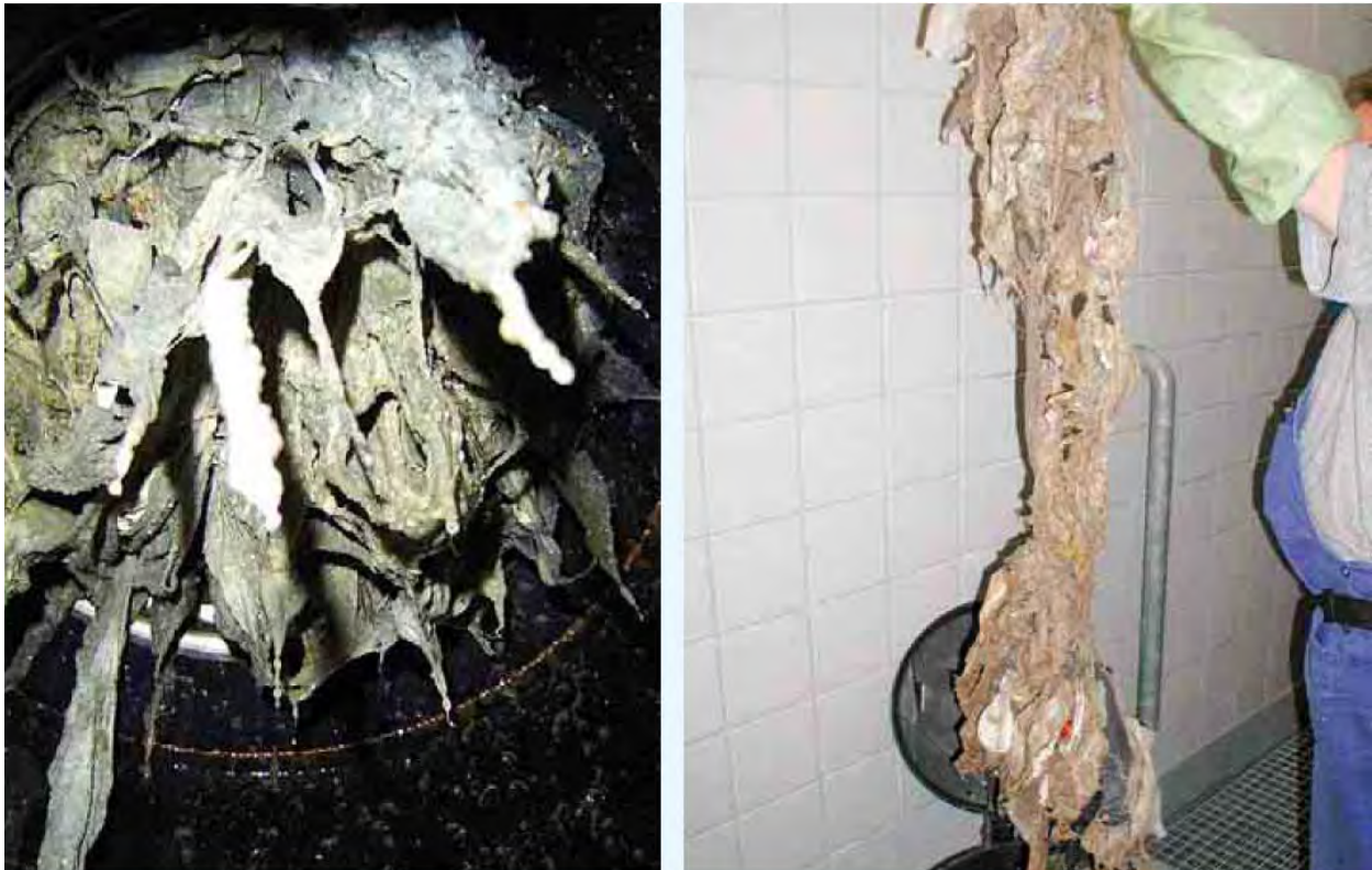
Abbildung 9-10 – Laufradverstopfung einer Abwasserpumpe (linke Abbildung) bzw. Verstopfungsszenarien durch zopfartige Gebilde (rechte Abbildung) (KRÖBER, 2010)
