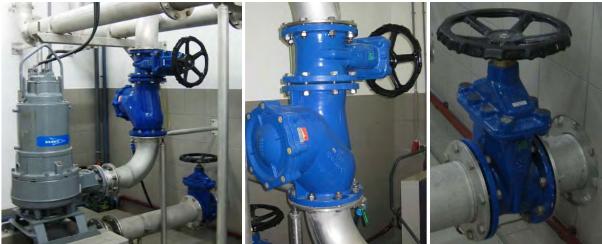
Abbildung 4-32: Armaturen in einer Pumpstation (Schitter)
